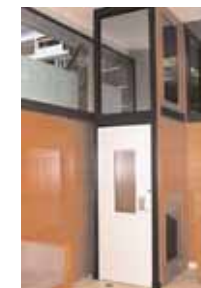
L'ascensore installato è un elevatore della OREM.
